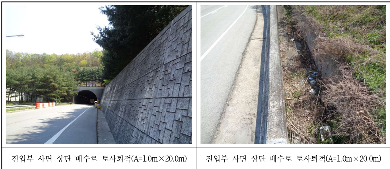
【사진 3.10】 사면 손상현황
